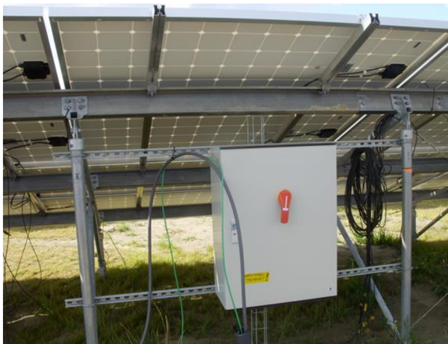
Zdj. 3. Poglądowe zdjęcie obrazujące inwerter
