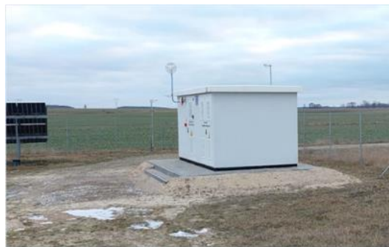
Pic. 3. Prefabrykowana stacja transformatorowa (pochodzenie: źródło własne)
