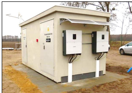
Fig. 7. Prefabrykowana stacja transformatorowa (pochodzenie: źródło własne)
