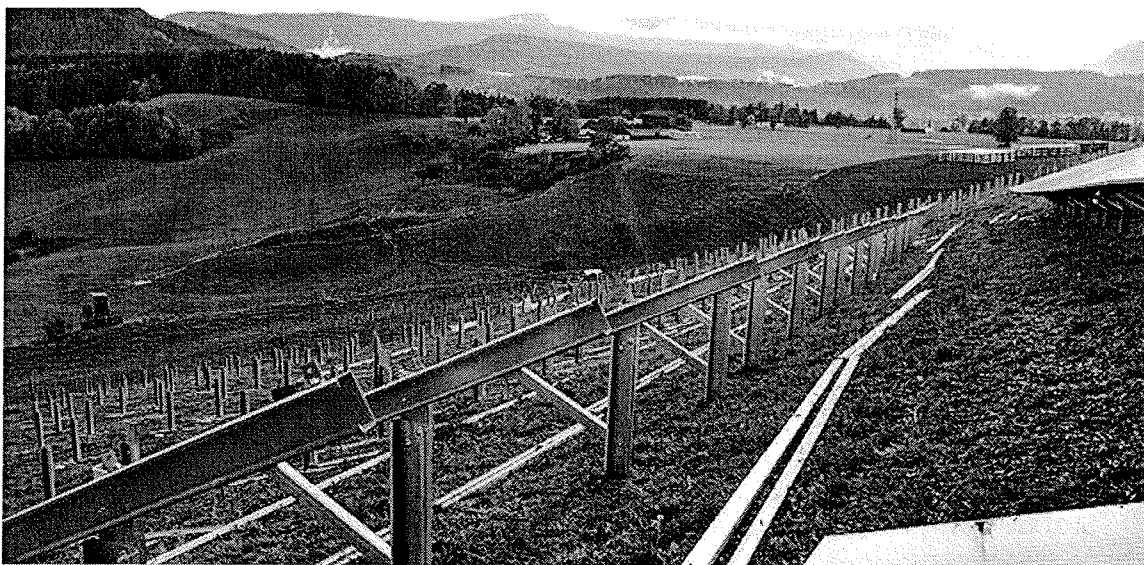
Zdjęcie 3. Konstrukcja przeznaczona do posadwienia paneli fotowoltaicznych.
