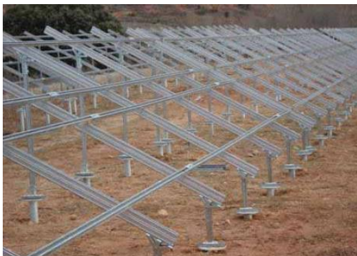
Rys. Ramy podtrzymujące panele fotowoltaiczne
