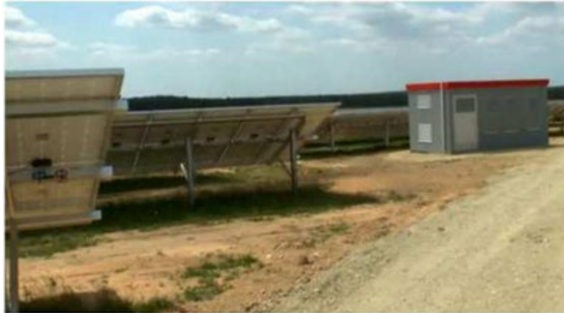
Rys. Konstrukcja instalacji fotowoltaicznej wraz z infrastrukturą elektroenergetyczną, drogową -przykład podobnej instalacji
