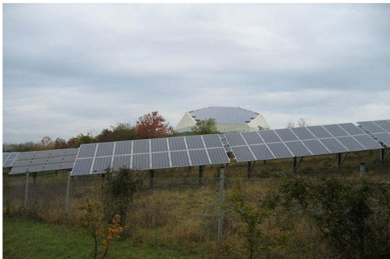
Rys. Farma fotowoltaiczna w Gondorf Kobern w Niemczech, źródło: http://de.wikipedia.org/wiki/Photovoltaikanlage_Kobern-Gondorf .
