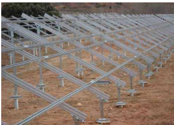
Ramy podtrzymujące panele fotowoltaiczne
