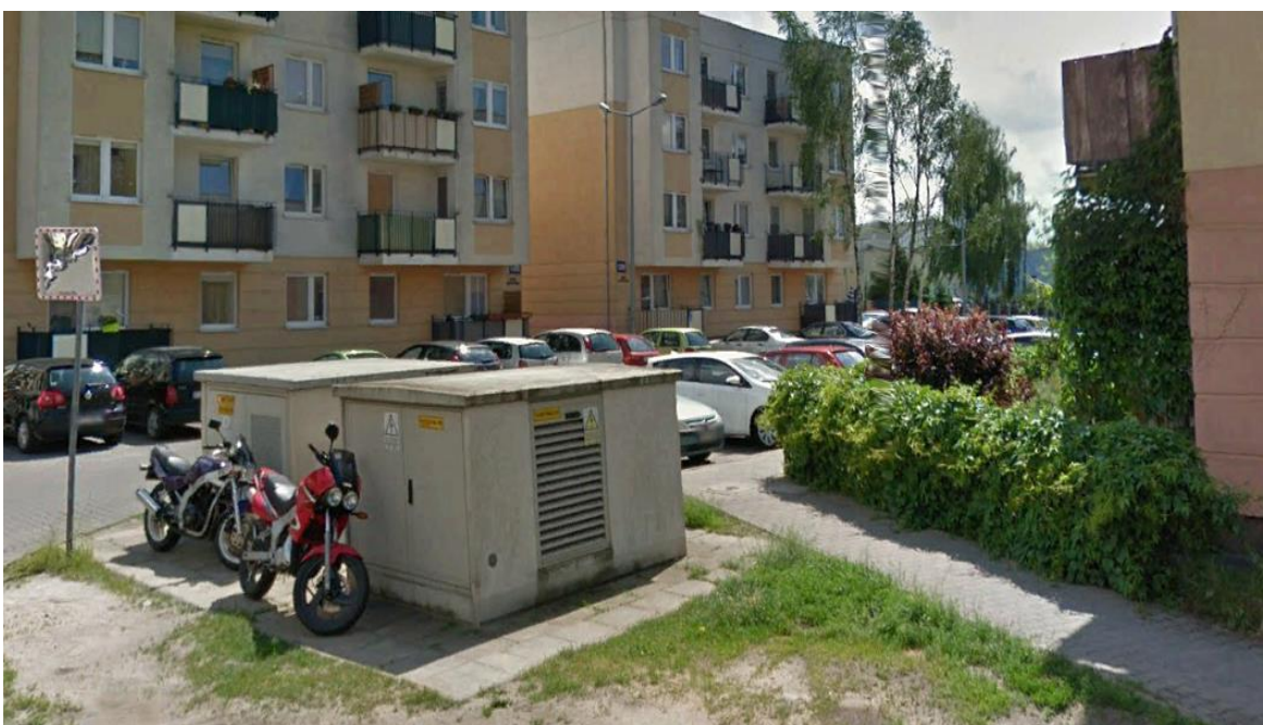
Rycina 12. Stacje transformatorowe w otoczeniu zabudowy mieszkaniowej.
