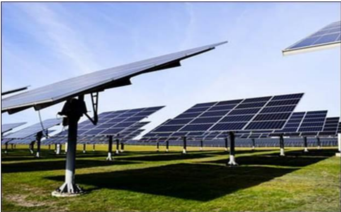
Rycina 6. Konstrukcja śledząca ruch słońca przeznaczona do posadowienia paneli fotowoltaicznych.
