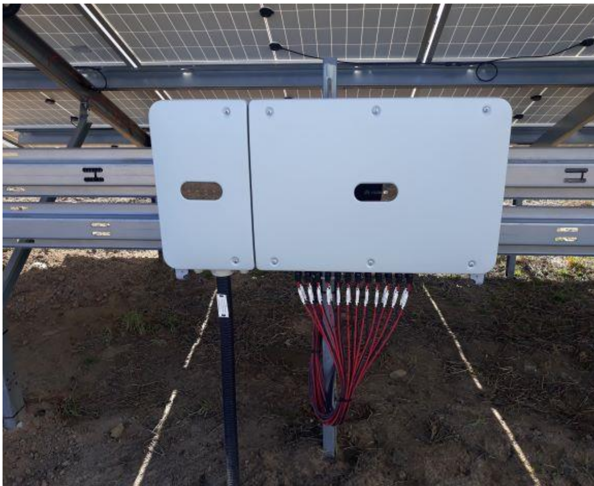
Rycina 9. Przykładowy inwerter farmy fotowoltaicznej.
