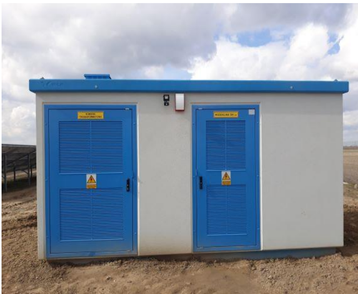
Rycina 10. Przykładowa stacja transformatorowa.
