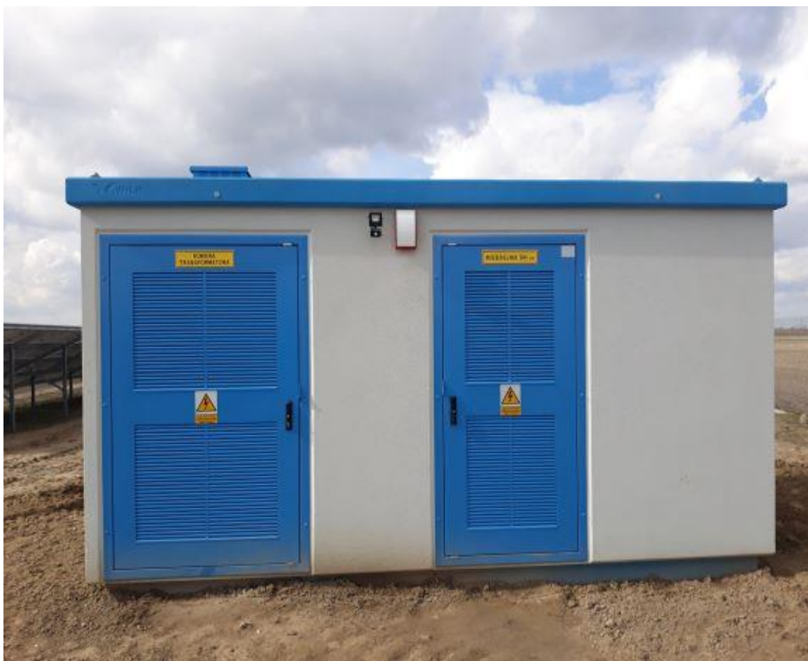
Rycina 10. Przykładowa stacja transformatorowa.
