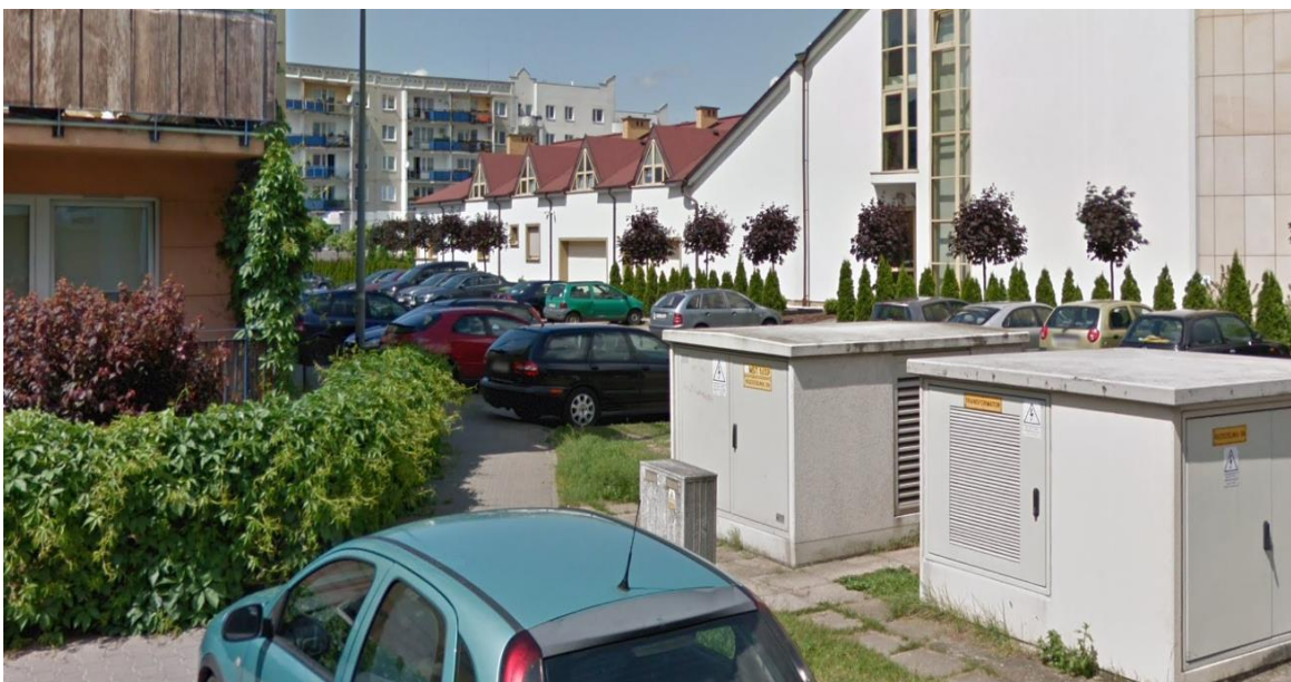
Rycina 11. Standardowa stacja kontenerowa w otoczeniu zabudowy.
