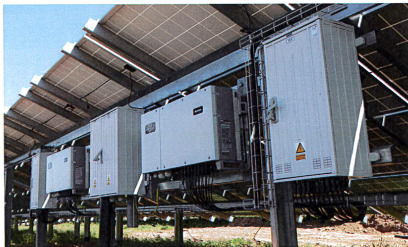
Rys. 12. Inwertery i rozdzielnie PV
