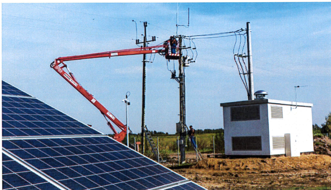
Rys. 13. Stacja transformatorowa z przyłączem energetycznym
